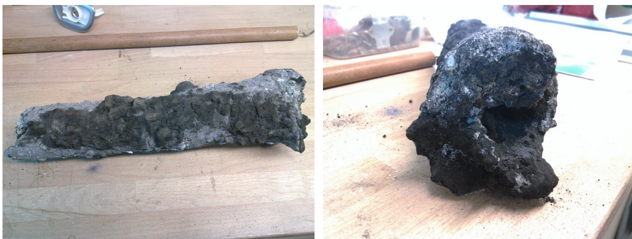
Illustration 2: Fejl på 10KV kabel, som blev opdaget tilfældigt ved nedgravning af lyslederkabler. Kablet har været udsat for en eller anden udefrakommende påvirkning (sandsynligvis lynnedslag), hvorefter kabelkappen ikke længere har kunnet opretholde sin isolationsevne. Det gråsorte på billedet er granitsten, som er smeltet ned over kablet, hvilket indikerer en ganske betydelig varmeudvikling. Bemærk venligst, at kablet var i drift, indtil fejlsituationen blev opdaget ved en tilfældighed (opgravning i forbindelse med anden kabelinstallation). Ovenstående er ikke en sjældenhed – der er mange kabler i samme stand, som stadig er i drift. I vores nuværende elektriske distributionsinfrastruktur findes der ingen overvågning over strømtabet i fejlbehæftede kabler.
